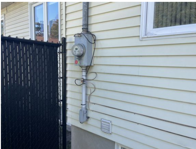
Branchement électrique aérien
