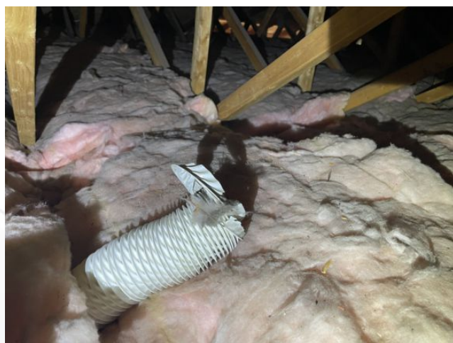
Ventilateur qui rejette son air dans le vide sous toit
