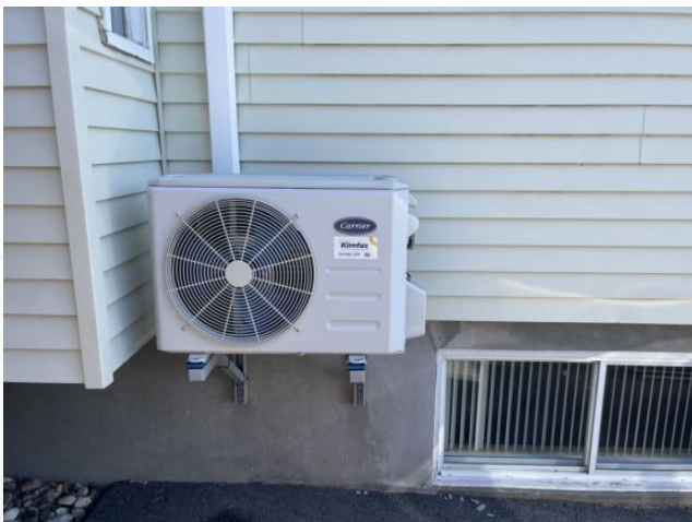
Unité externe de climatisation
