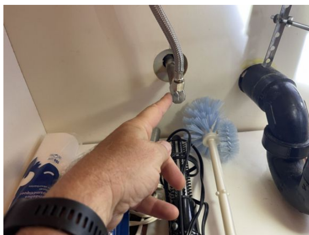
Absence de valve d'arrêt sur les conduites d'alimentation
