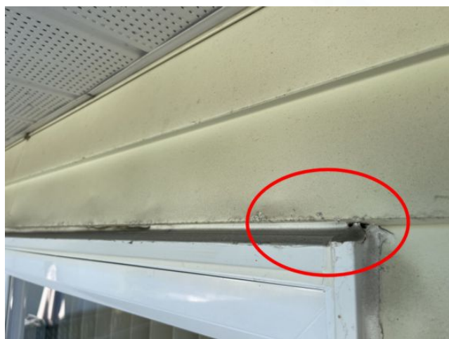
Ouverture au pourtour du conduit de la thermopompe [Façade arrière du bâtiment]
