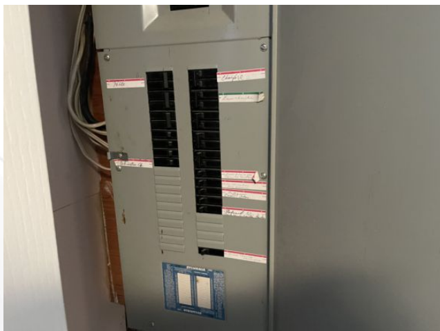
Panneau électrique de marque Sylvania
