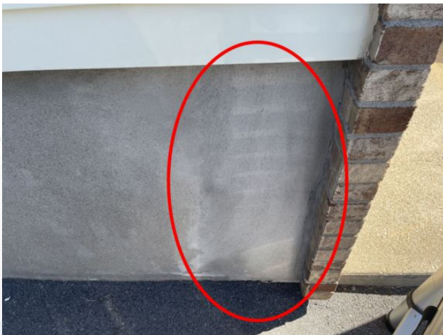
Fissure réparée sur la fondation
