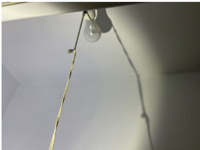
Ampoule nue et sans protection dans un placard à vêtement
