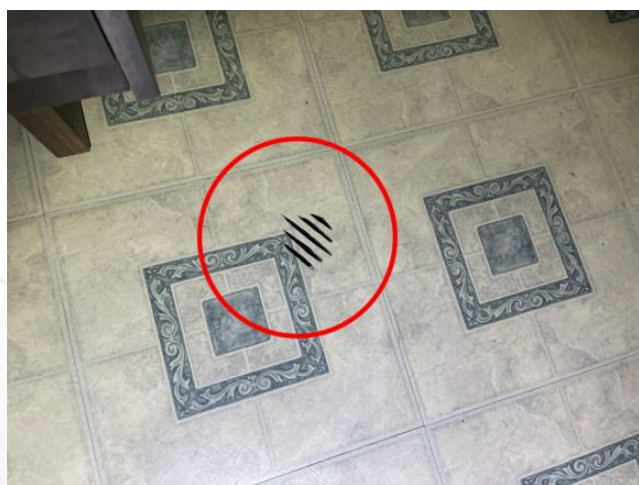
Drain de plancher obstrué par le revêtement de sol découpé
