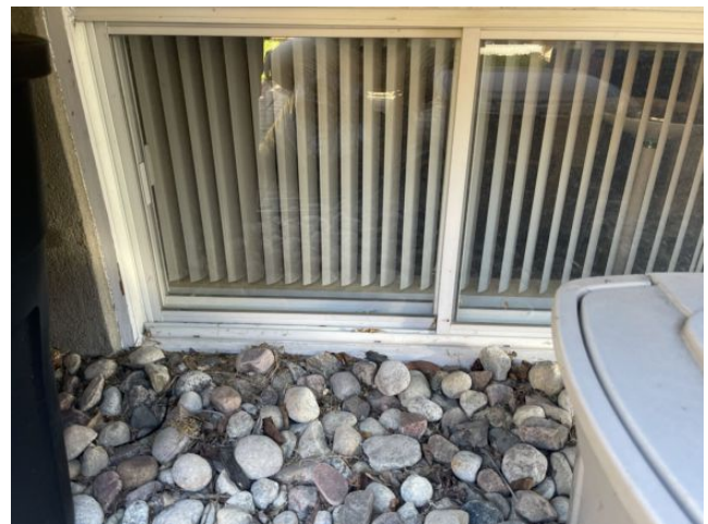
Dégagement insuffisant de la fenêtre avec le niveau du sol [Coin arrière de la façade gauche du bâtiment]
