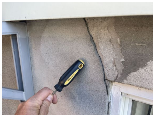
Crépi détaché en bordure de la fissure
