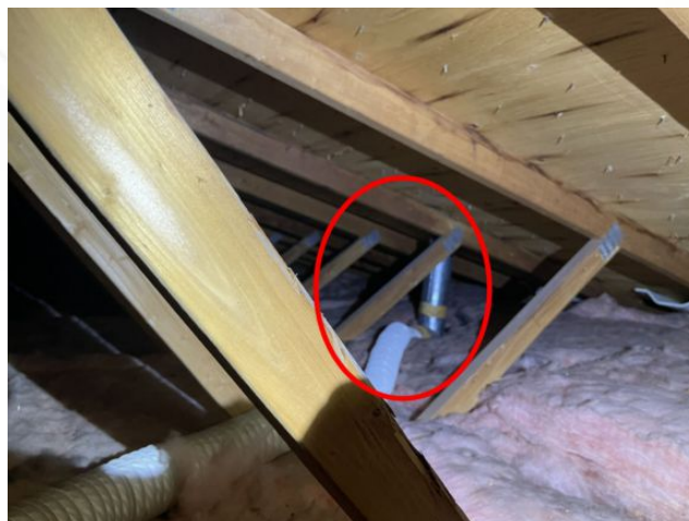
Conduits de la hotte et du ventilateur de salle de bain reliés ensemble
