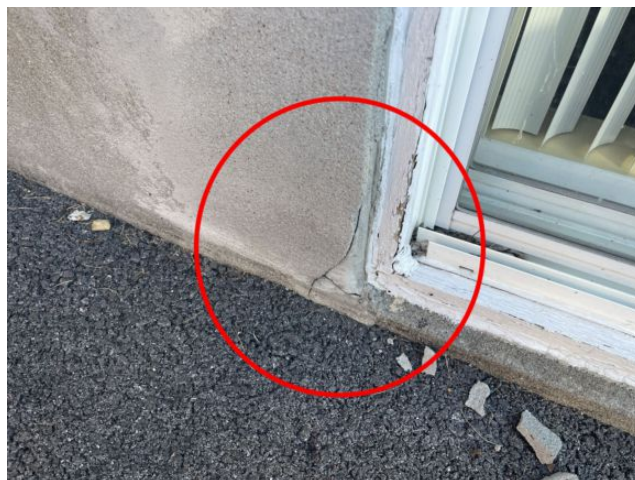
Fissure qui peut se prolonger sous le niveau du sol
