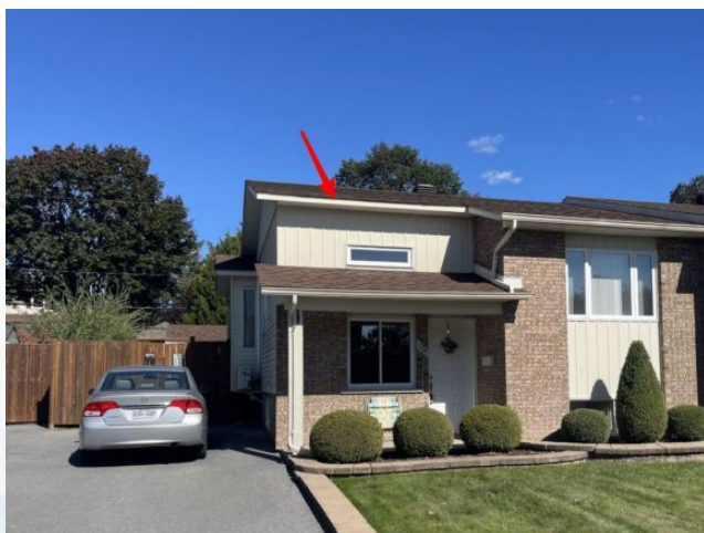
Absence de gouttières et descentes pluviales
