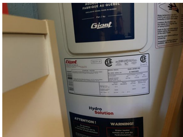
Plaque signalétique du chauffe-eau
