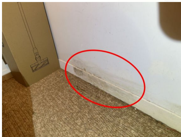
Présence de taches s'apparentant à des moisissures à la base du gypse au sous-sol
