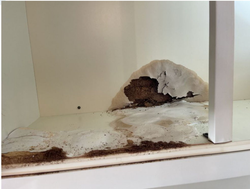
Domage significatif au cabinet d'armoire localisé au-dessus de la cuisinière
