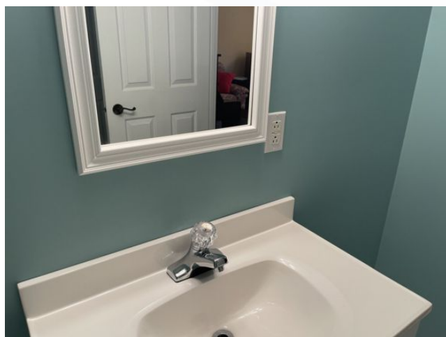
Prise de courant installée derrière un lavabo
