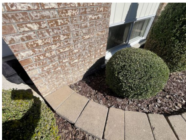
Brique enterrée sous la terre de la plate-bande de végétation
