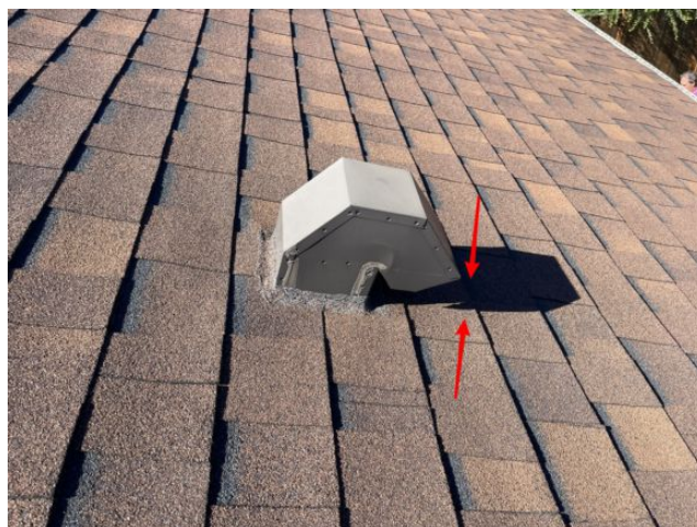
Sortie de la hotte de cuisinière trop près du toit
