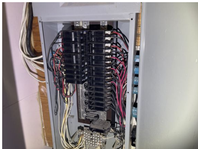
Panneau électrique ouvert
