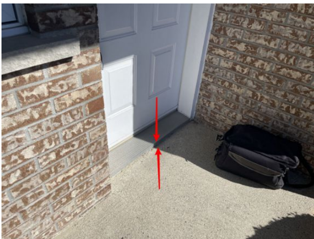
Dégagement du sol insuffisant avec la porte
