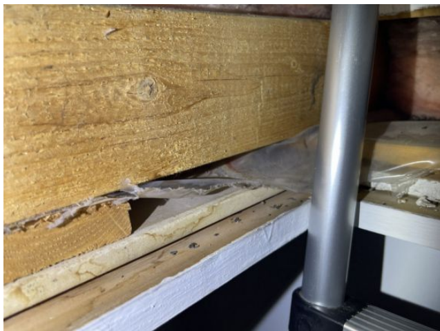
Absence de joint d'étanchéité au pourtour de la trappe
