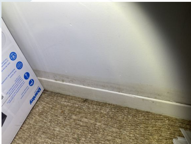
Présence de taches s'apparentant à des moisissures à la base du gypse au sous-sol [Sous l'escalier au sous-sol]
