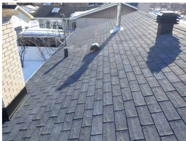
Revêtement de bardeaux d'asphalte détérioré
