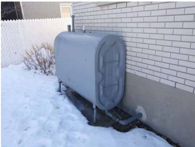
Réservoir au mazout
