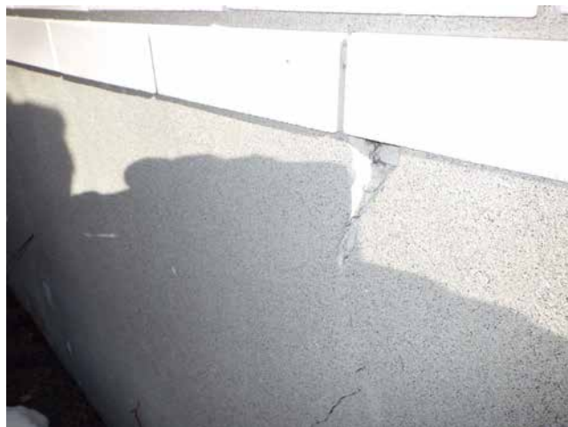
Fissure nécessitant une réparation [Façade avant du bâtiment]
