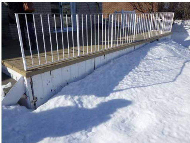
Accès sous la terrasse bloqué par la neige
