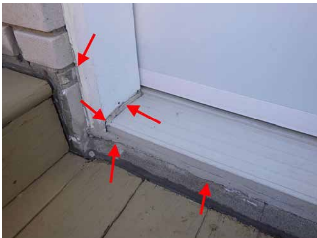
Scellant détérioré au pourtour des ouvertures
