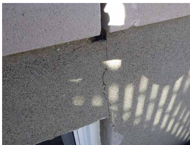
Fissure à réparer au coin de la fenêtre [Façade droite du bâtiment]
