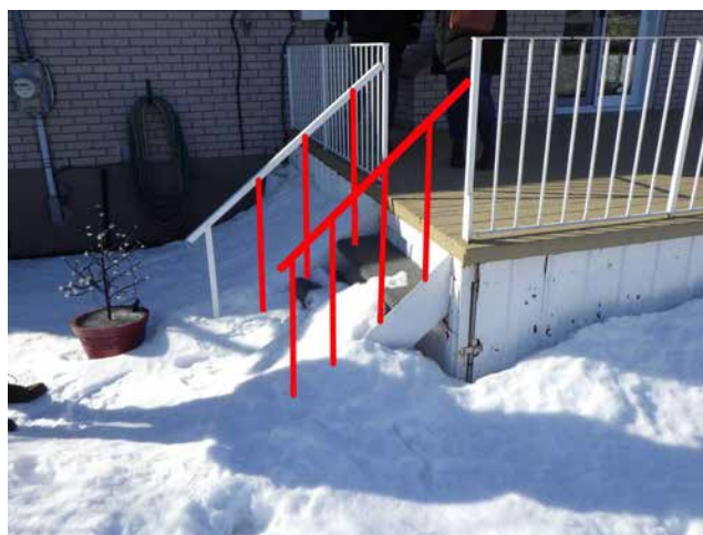
Absence de balustrade en bordure de l'escalier
