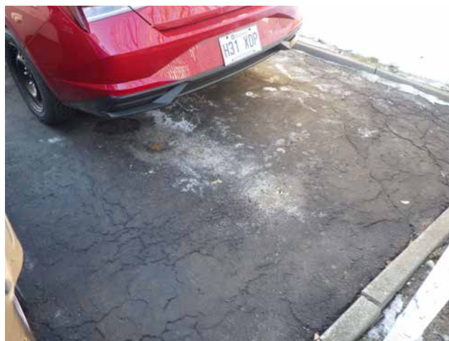
Fissure sur le stationnement
