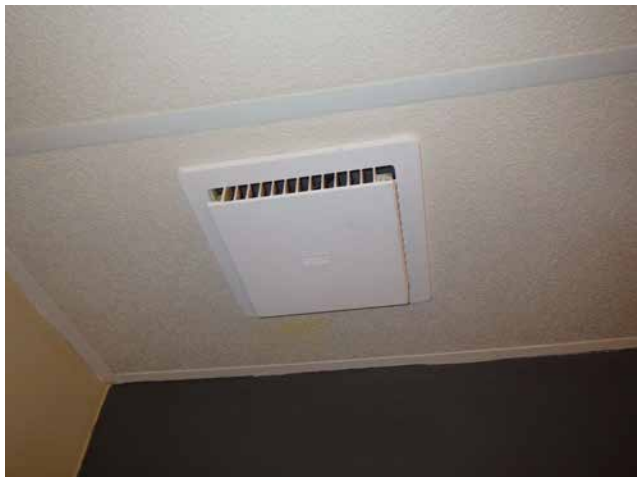
Ventilateur inefficace dans la salle de bain [Salle de bain du sous-sol]
