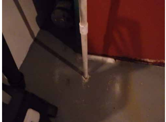
Conduit du condensât de la fournaise dirigé sous la dalle de béton
