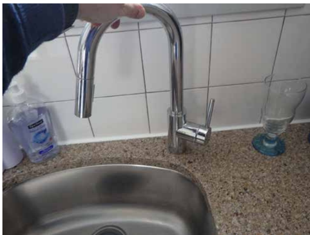
Robinet d'évier mal fixé [Cuisine du rez-de-chaussée]
