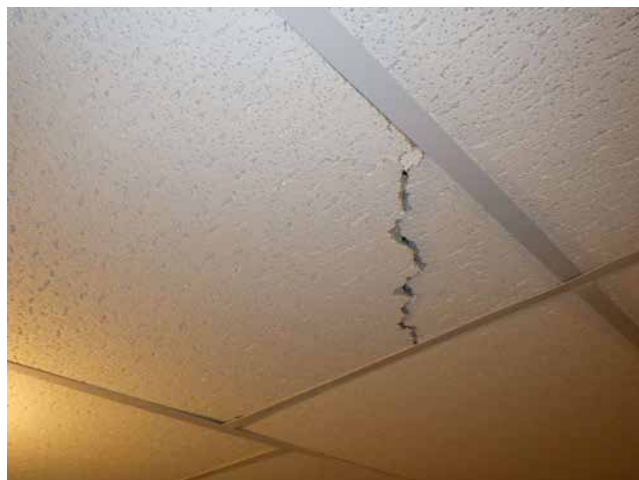
Tuile de plafond endommagée
