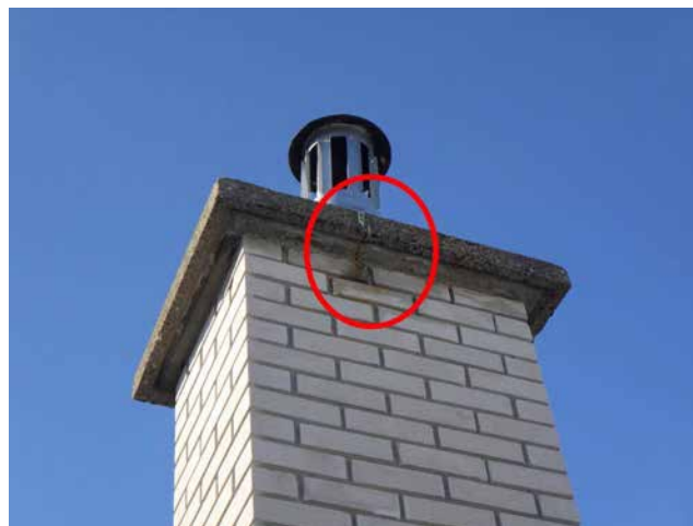
Couronne de la cheminée fissurée
