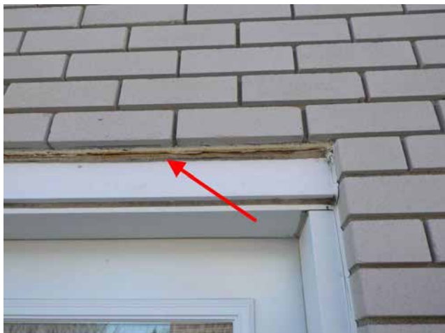
Joint de scellant bloquant le drainage du mur extérieur au dessus de la porte
