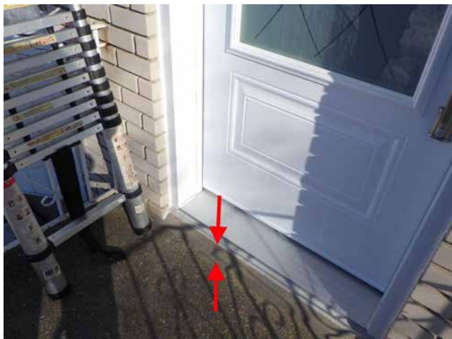
Dégagement du sol insuffisant avec la porte
