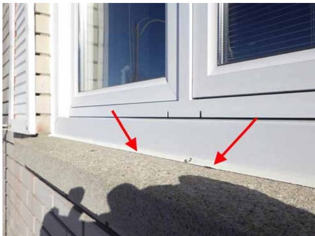
Cadre de fenêtre à calfeutrer [Façade avant du bâtiment]
