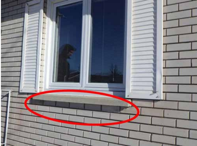
Absence de chantepleure sous l'allège de la fenêtre
