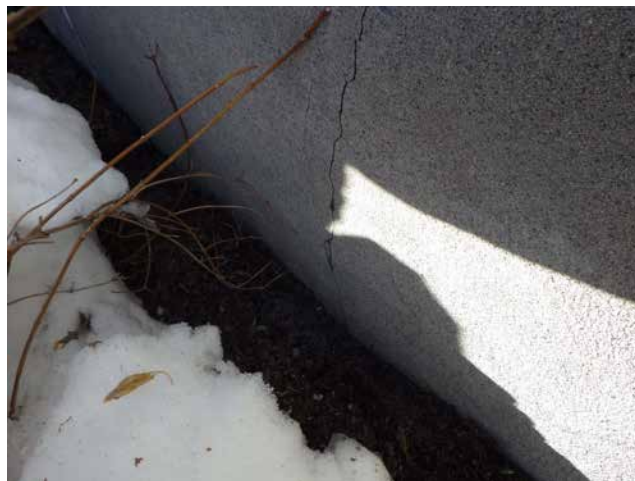
Fissure se prolongeant sous le niveau du sol
