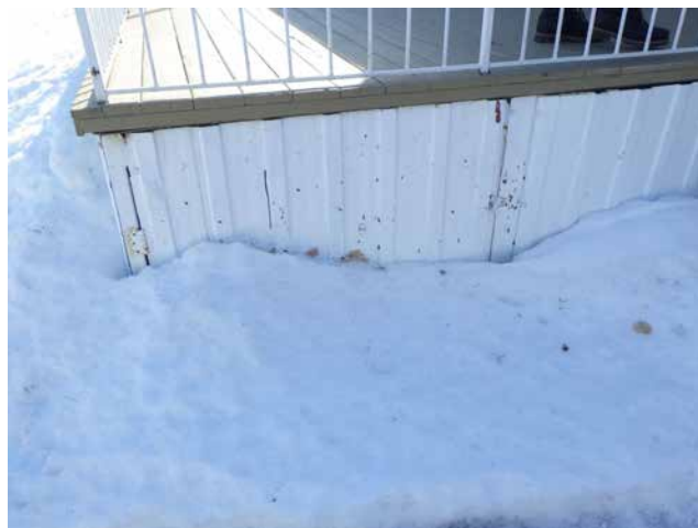
Porte d'accès bloquée par la neige
