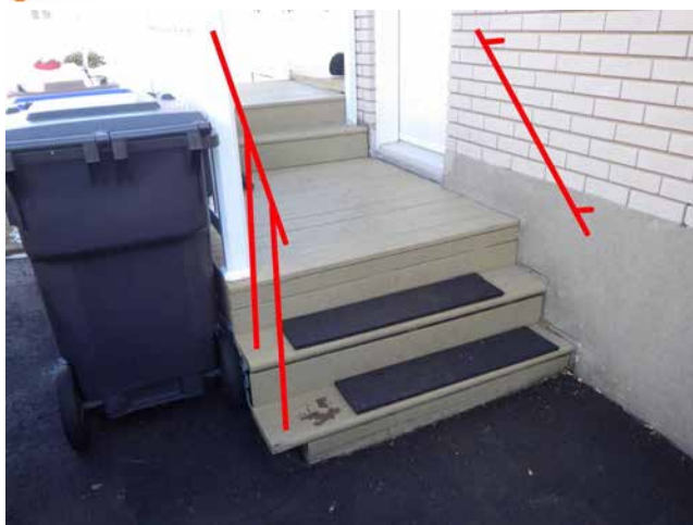
Absence de main-courante en bordure de l'escalier
