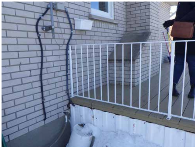
Balustrade et main-courante trop basse
