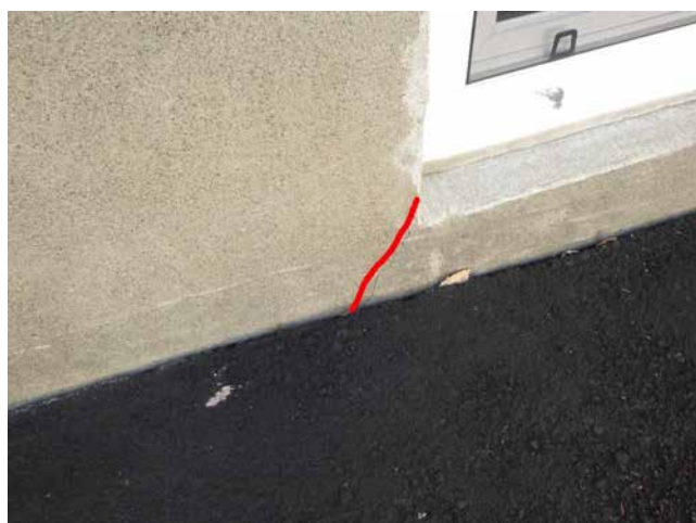
Fissure se prolongeant sous le niveau du sol [Façade gauche du bâtiment]
