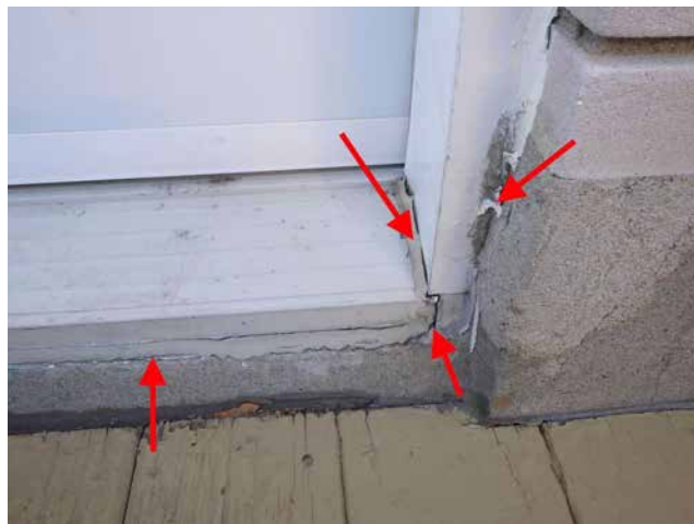
Bois exposé au coin de la porte extérieure [Coin arrière de la façade gauche du bâtiment]
