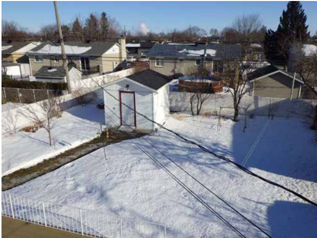
Câble de branchement au dessus de la cour arrière
