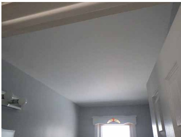
Absence de ventilateur dans la salle de bain du rez-de-chaussée [Salle de bain du rez-de-chaussée]
