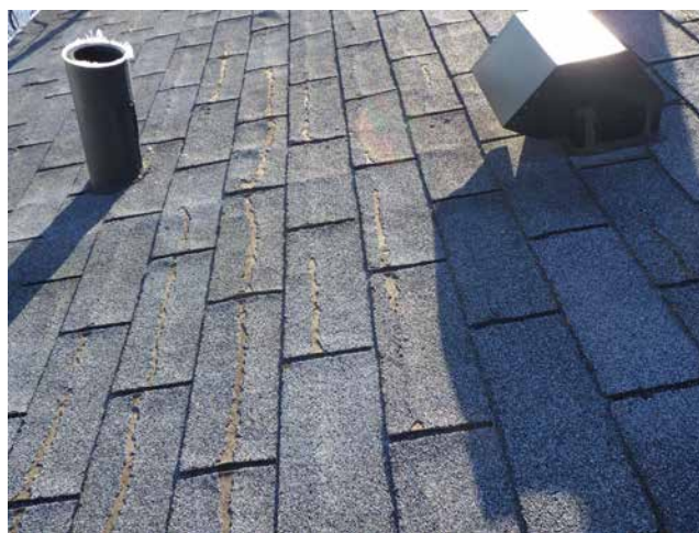
Détérioration avancée du toit
