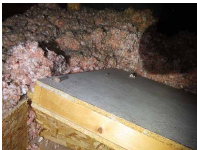
Trappe d'accès mal scellée et mal isolée
