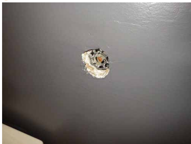
Valve d'eau principale inaccessible
