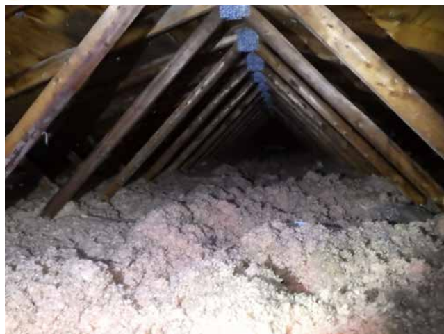
Isolation inégale des combles
